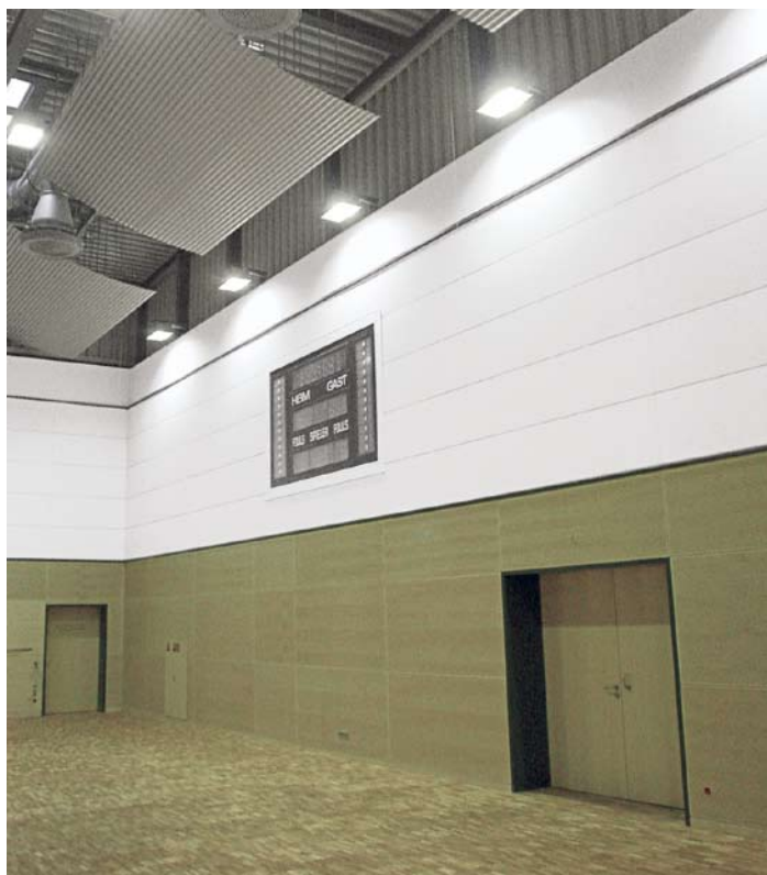
Wände. Die unteren Wandbekleidungen bestehen aus perforierten MDF-Platten mit Echtholz-Furnier, die oberen aus ballwurfsicheren Schall absorbierenden Spanplatten.
