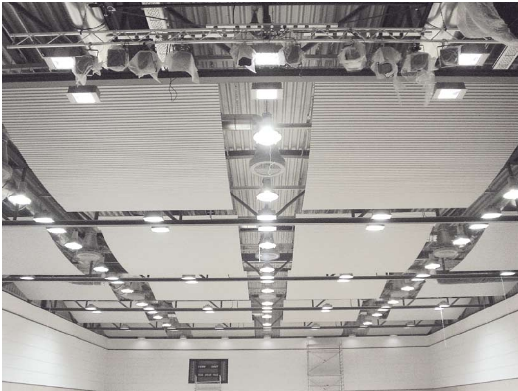
Marke Eigenbau. Wesentlicher Bestandteil des raumakustischen Konzeptes sind die geneigten und gewölbten GK-Deckensegel mit Alu-Wellen. Sie haben eine Schall lenkende und diffus streuende Funktion und sind ballwurfsicher ausgelegt.
